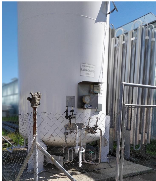
1. kép Széndioxid tartály, adagoló rendszer hőcserélővel
