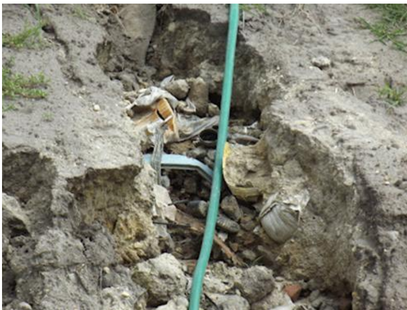
21. ábra Erózió által megrongálódott részsű a hasadékból kibukkanó hulladékkal (ocsa-varos.blogspot.hu)
