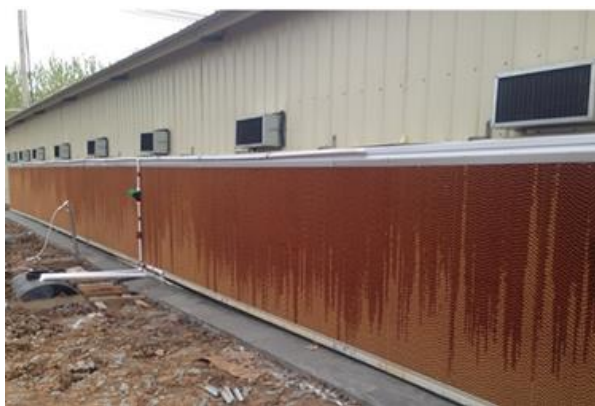
26. ábra: Baromfiistálló hűtőpaneles hűtése [25]
